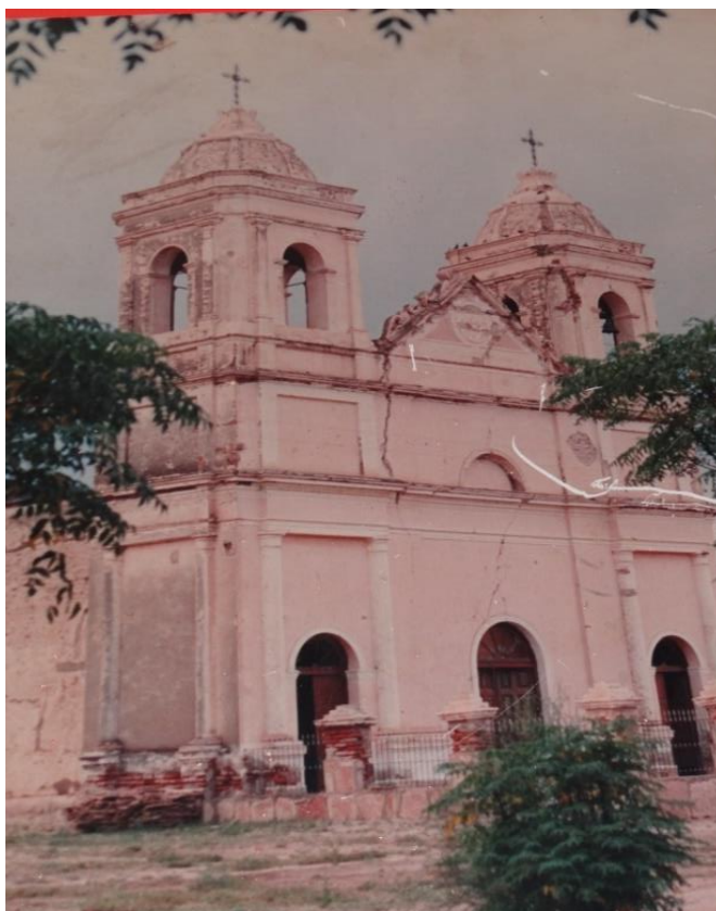
Figura 5. Imagen del Templo de San Nicolás de Bari anterior al derrumbe del frente.
